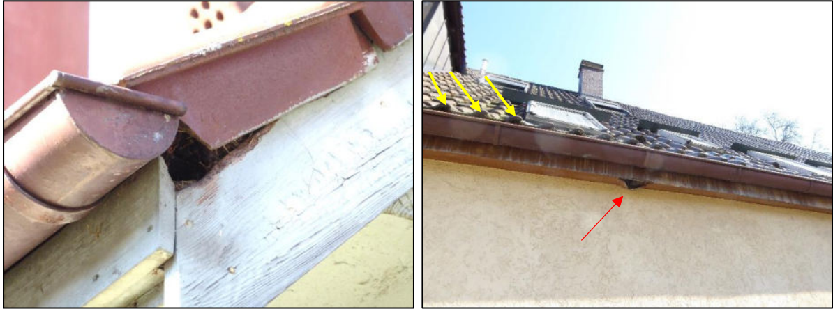
Abbildung 9: Schadhellen an den Gebäuden der Seestraße 14 (linkes Bild) und der Seestraße 10 (rechtes Bild, roter Pfeil). Im linken Bild ist zudem altes Nistmaterial erkennbar. Die gelben Pfeile im rechten Bild weisen auf potenzielle für gebäudebrütende Vögel geeignete Strukturen im Übergangsbereich von Regenrinne zu Dachziegeln hin.
